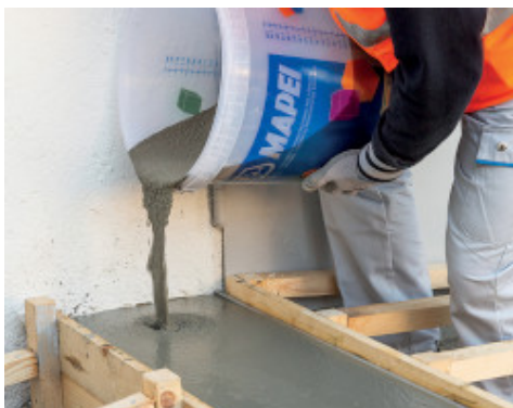
Oprava a zvýšení tloušťky betonové stěny s použitím výrobku Mapegrout Ancora & Ripara
