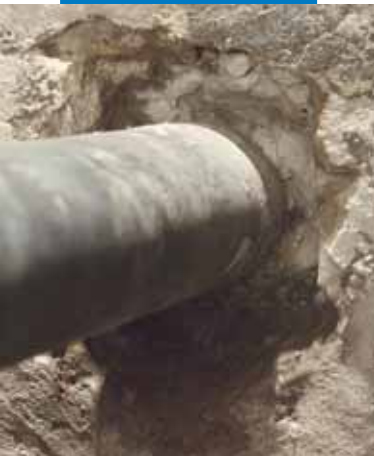
Lokální odbourání v okolí potrubí
