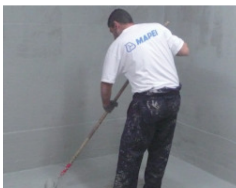
Aplikace Mapelasticu Foundation válečkem při hydroizolaci proti tlakové vodě v negativním směru
