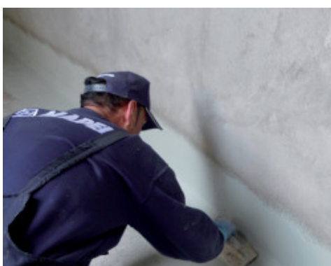
Aplikace Mapelasticu Foundation stěrkou při hydroizolaci proti tlakové vodě v negativním směru
